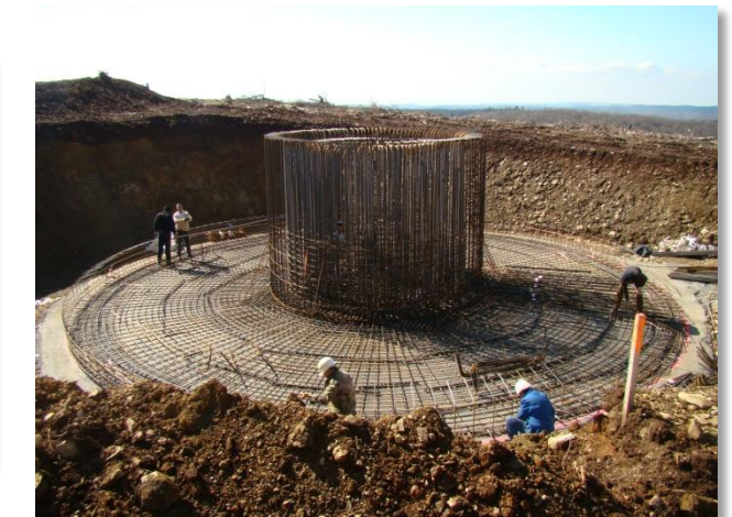
Armature (Photo : VALOREM)
